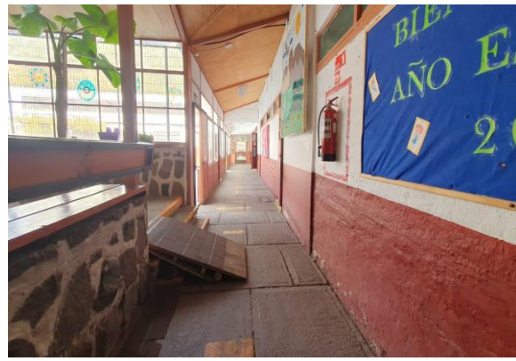
Estado actual de pavimentos.
