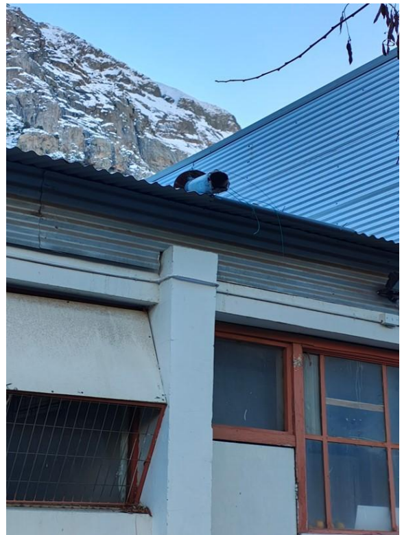
Elementos de techumbre afectados por el temporal
