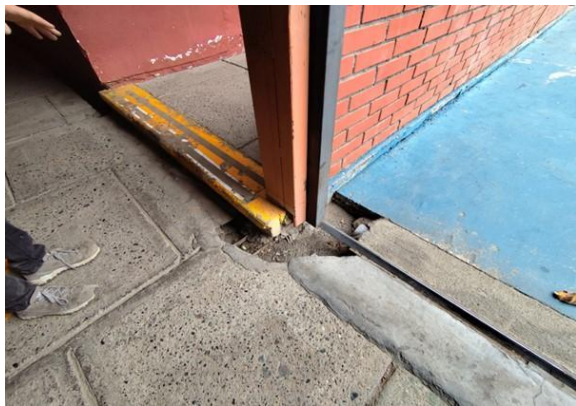
Estado actual de pavimentos.
